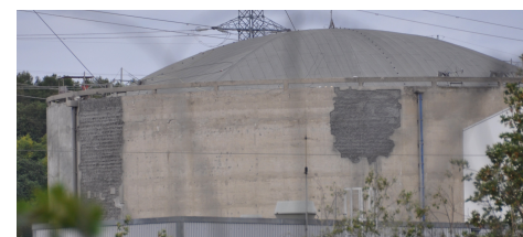
Het reactorgebouw van Tihange 2 vertoont
